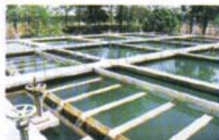
Estação de Tratamento de Água - ETA (vazão de 200 litros/segundo de água tratada)
