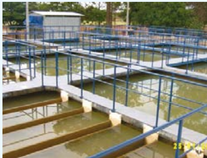
ETA - Estação de Tratamento de Água
